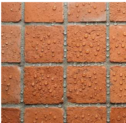
PAVIMENTI ASSORBENTI, FUGHE PIASTRELLE
