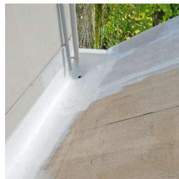
PLUVIALI SOGGETTI A RISTAGNO
